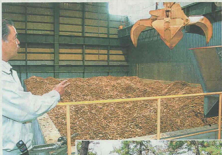
発電施設内でガス化炉に運ばれる木材チップ —昨年5月、宝達志水町針山
